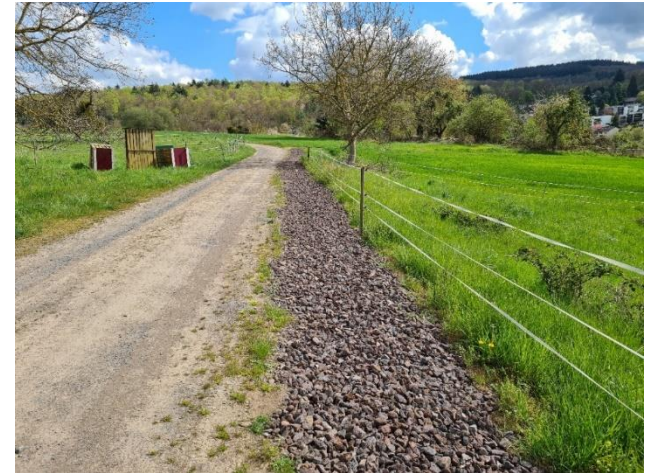
Straßenbegleitende Rigolen in Oberbieber, Quelle: BCE
