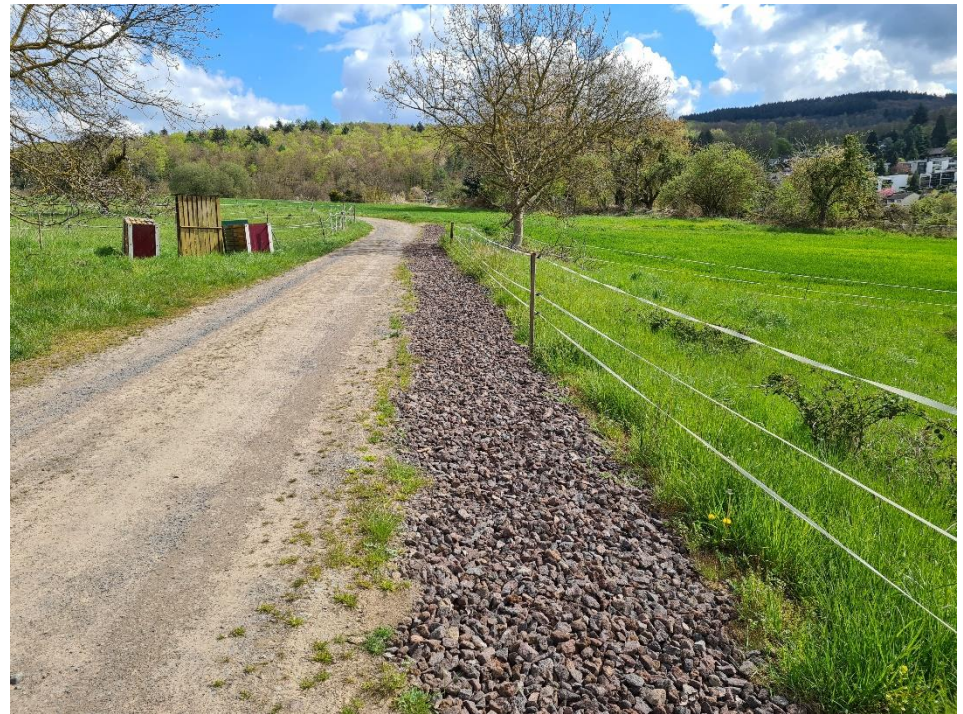
Foto: Straßenbegleitende Rigolen in Oberbieber, Quelle: BCE
